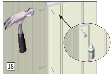
18) Denna spikas på plats med ett avstånd på c/c 300 mm. Spikhuvuden kan döljas med bättringsfärg. Vi levererar bättringsfärg i originalet för att du ska kunna dölja spik- eller skruvhuvuden eller små skador på skivan. Var försiktig när du bättringsmålar då våra skivor är penselmålade i strukturen.
